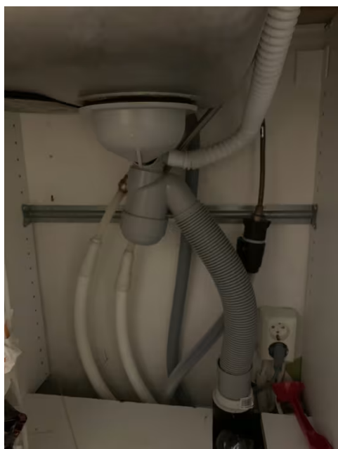
Avløpsrør i underskap vask på hybelkjøkkenet.
