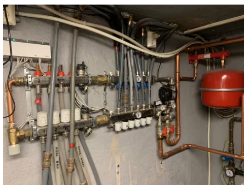
Åpen rørfordeling vannbåren varme plassert på teknisk rom.
