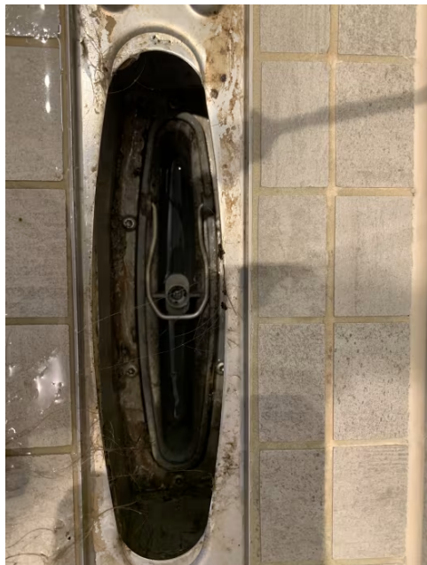
Langsluk plassert i dusjsonen.
