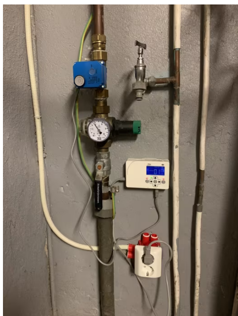
Vannmåler og stoppekran plassert på tekstil rom.
