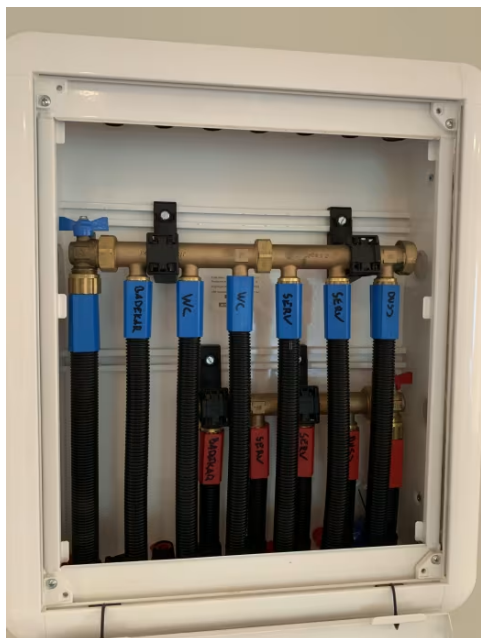
Rørfordelskap plassert i vegg på bad1..
