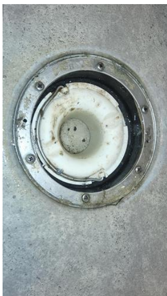
Avløpsrør (ink. sluk) - [Sluk bad]
