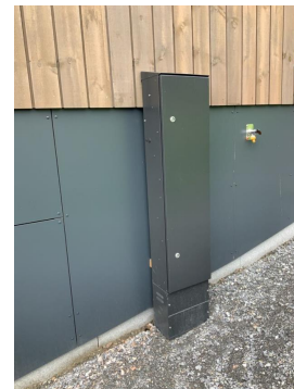
Inntaksskap på yttervegg.3x50A
