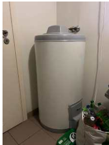
Varmtvannsbereider på vaskerom.
