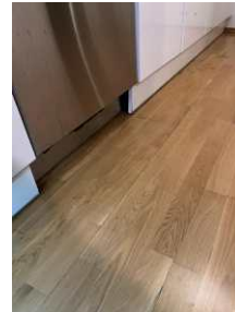
Noe åpning mellom bordene på gulv.
