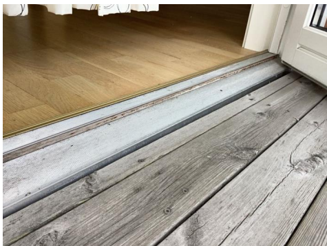
Liten høydeforskjell mellom tredekke og dør
