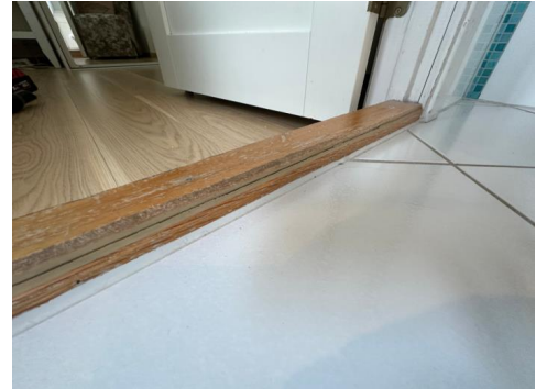
Overgang mot dørterskel.
