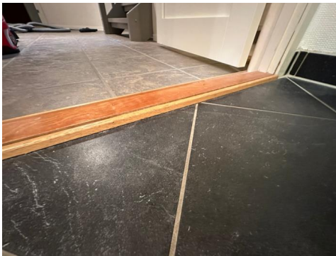
Overgang mot dørterskel.
