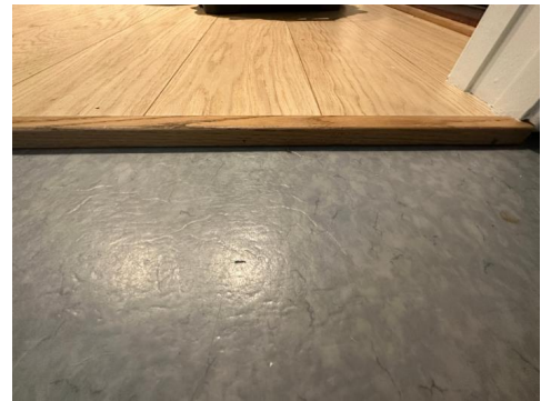
Overgang mot dørterskel.
