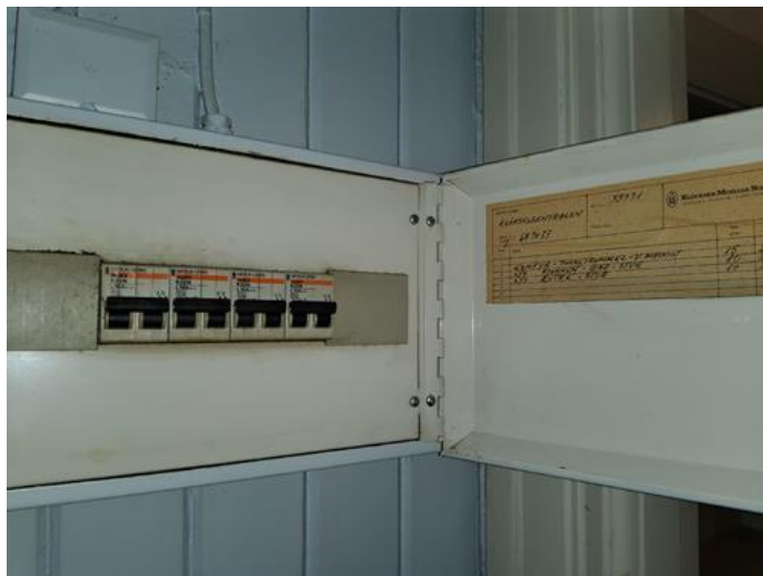
Elektrisk anlegg - [Sikringsskap og kursfortegnelse ]
