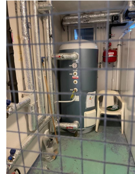
Felles varmtvannstank i u-etg.
