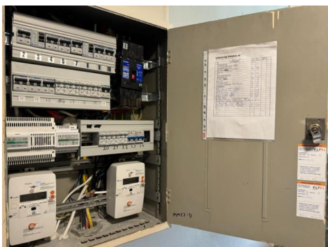
Sikringskap i fellesarealer.
