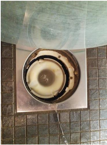
Avløpsrør (ink. sluk) - [Sluk bad]
