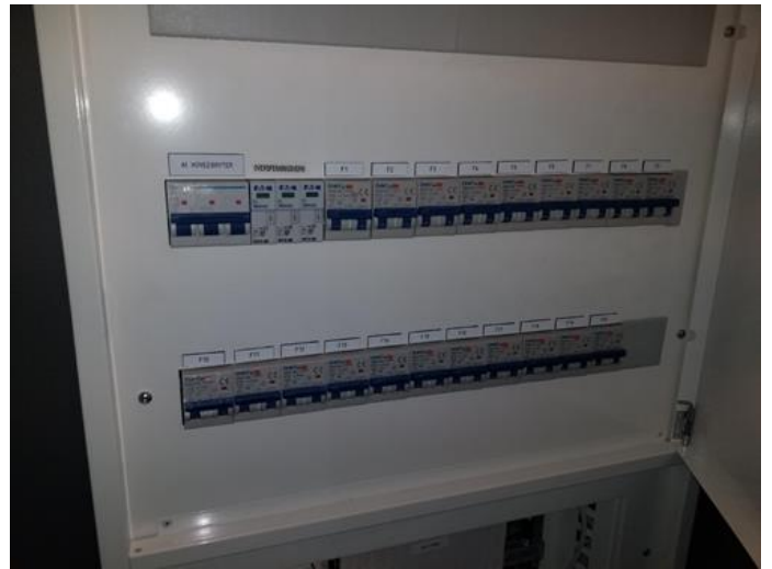
Elektrisk anlegg - [Sikringskap.]
