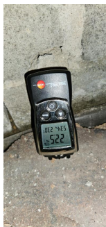
Fuktmåling i tilfarergulvet i bod. 22,5% målt.
