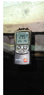
Fuktmåling under garasjedekket. 29,5% målt.
