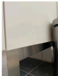
Fuktskader i baderomsinnredning.
