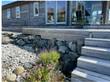
Manglende rekkverk på terrasser over 50cm fra bakkenivå.
