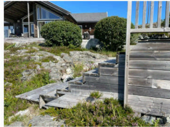
Manglende rekkverk i trapp ut fra forskrifter på oppføringstidspunkt.
