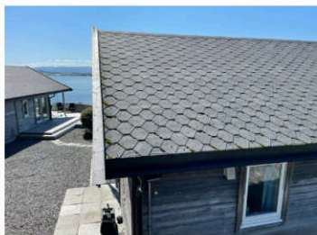
Bildet viser mose på tak.
