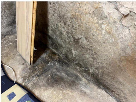
Synlig fuktgjennomtrengning i kjeller.
