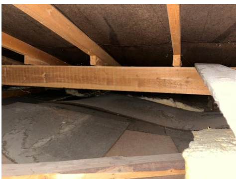
Fuktskjolder i undertak.
