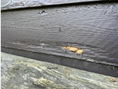
Råteskade i kledning, nord-vegg.
