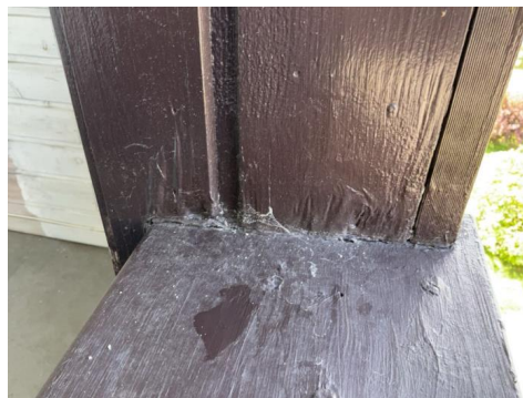
Råteskader i panel rundt stolper balkong 2.etg.
