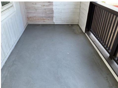
Glassfiber membran. Ingen drenering fra balkong.
