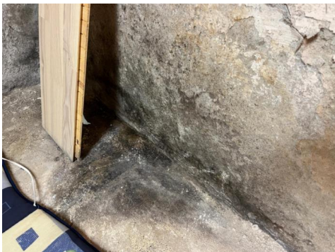
Fuktgjennomslag i kjeller.
