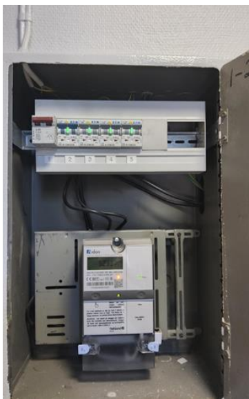
Elektrisk anlegg - [Sikringskap]
