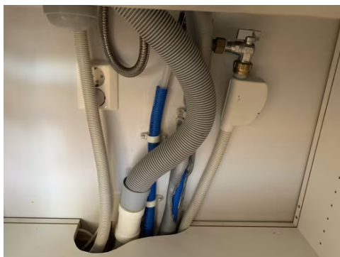
Avløpsrør i underskap vask på kjøkkenet.
