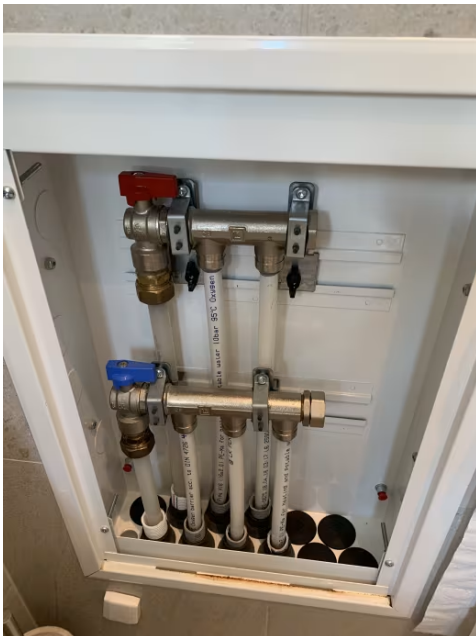
Lokal rørfordeling i vegg badrom 2. etg.
