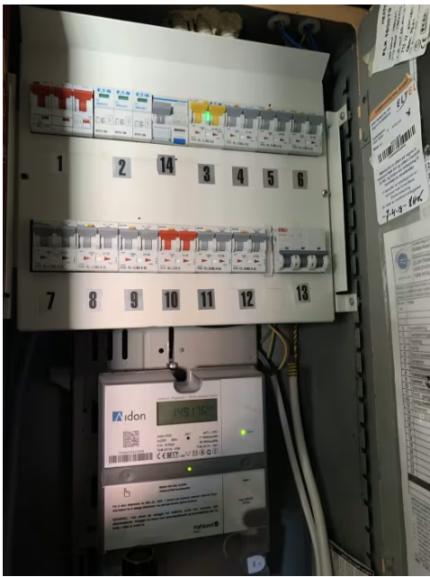
Hovedsikringskap plassert i skap i entre.
