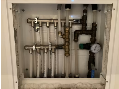
Hovedfordelerskap plassert i vegg under benk på vaskerom.
