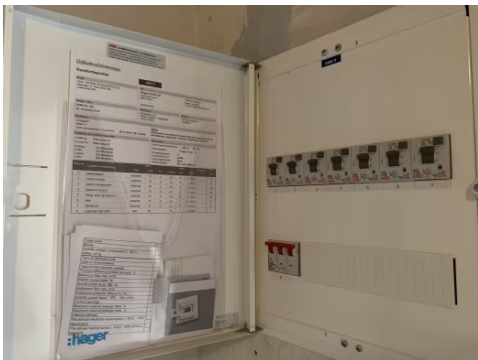
Lokal sikringskap for 1 etg, med kursfortegnelse plassert i bod i 1. etg.
