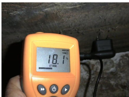
Høy fuktighet i gulvbord ut mot innside av grunnmur
