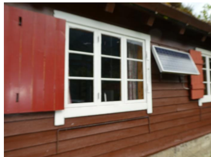
Mangler beslag /vannbrett i underkant vinduet
