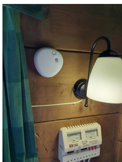
Ny røykvarsler ved side av sikringsskap for solcelleanlegget
