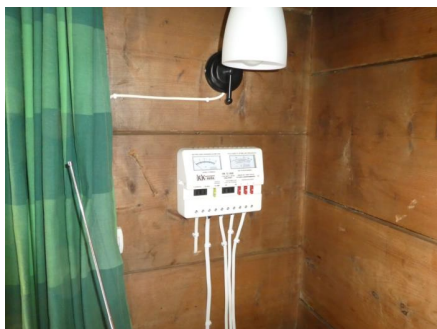
Innvendig fordeling og sikringsskap
