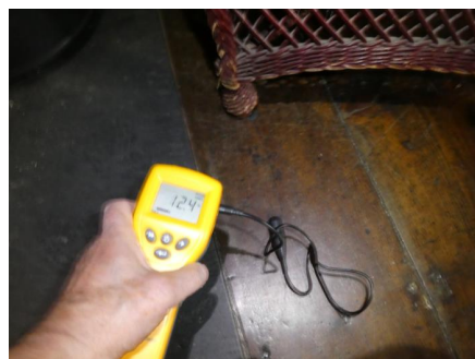
I stuen er det målt 12,4 vekt% fukt i gulvbordene.
