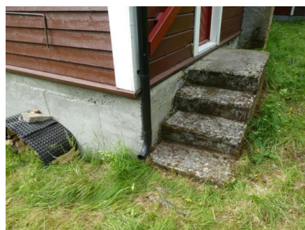
Betongtrapp mangler rekkverk
