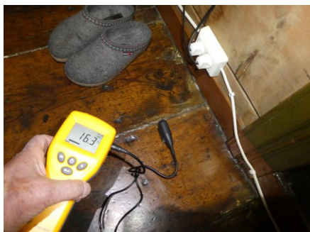
Nær ved yttervegg er det målt 16,3 vekt% fukt i gulvbordene.
