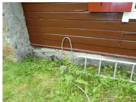
Svekket grunnmur i nordfasaden
