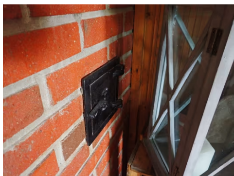
For kort avstand fra sotluke til brennbart materiale.
