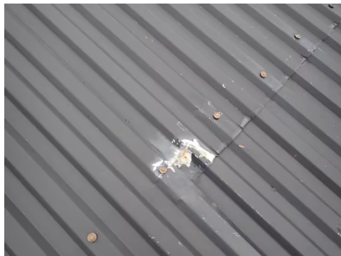
Skade i takplate.
