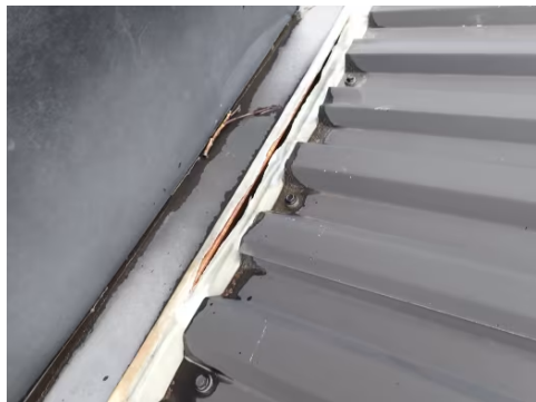
Skade/ sprekk i pipebeslag.
