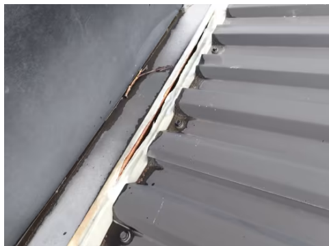
Sprekk i pipebeslag.
