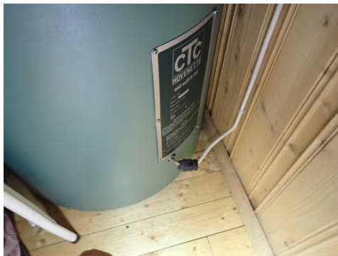
Ledningsgjennomføring er ikke festet forskriftsmessig.
