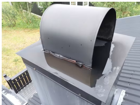
Rust i takhatt.
