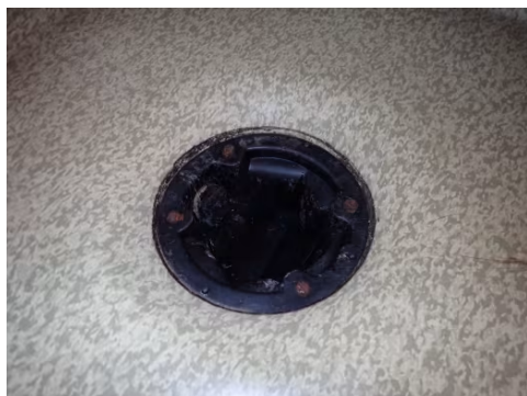
Slukløsning med belegg under klemring, det registreres rust i skruer for klemring.
