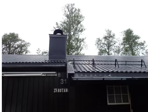
Ikke etablert forskriftsmessig takstige for feier.
