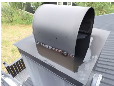
Rust i takhatt.
