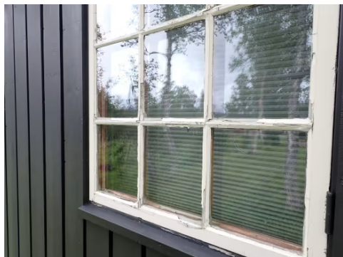
Værslitte vinduer og karmen med løse kittfalsen i glassruter.
