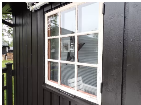
Sprekk i vindusrute soverom 2.
