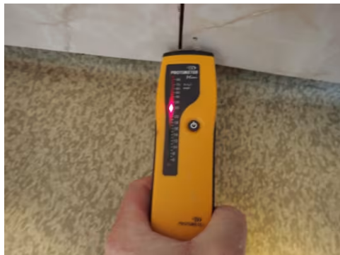
Fuktsøk med registrerte forhøyde fuktverdier i våtromsplater.
