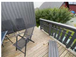
Mangler rekkverk på deler av balkong.
