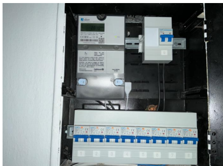
Automatsikringer i sikringsskap plassert i gang/fellesareal.
