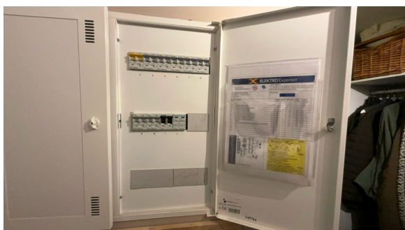
Sikringsskap plassert i entre.
