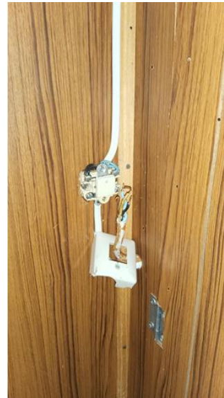
Forenklet vurdering av det elektriske anlegget - [Skadet bryter i entre]
