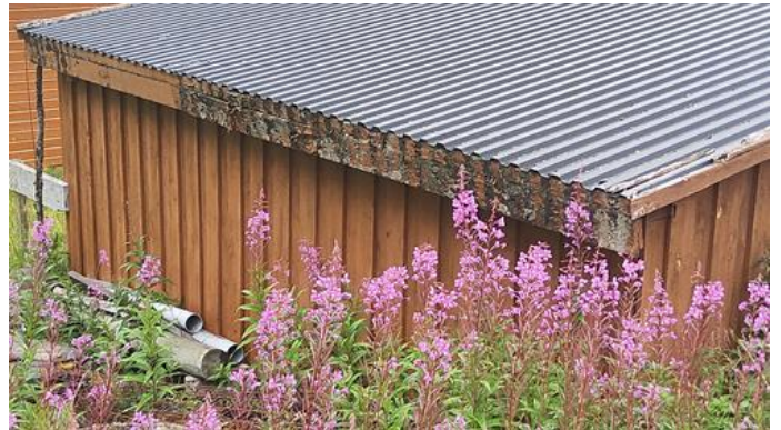
Kommentar - [Råteskade i forkantbord på tak til utvendig bod]
