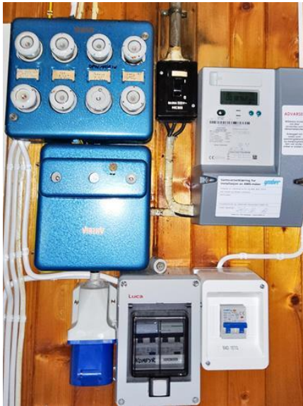
Forenklet vurdering av det elektriske anlegget - [Sikringsbokser]
