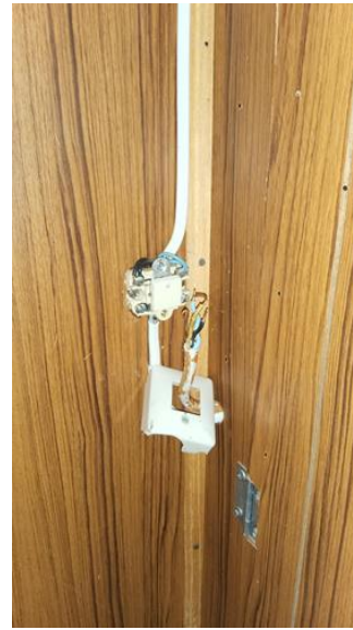
Forenklet vurdering av det elektriske anlegget - [Skadet bryter i entre]
