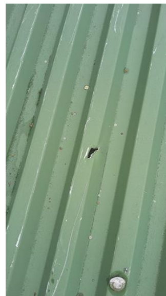
Helhetsvurdering - [Hull i yttertak over stue]
