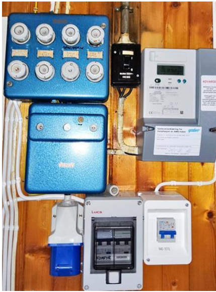
Forenklet vurdering av det elektriske anlegget - [Sikringsbokser]
