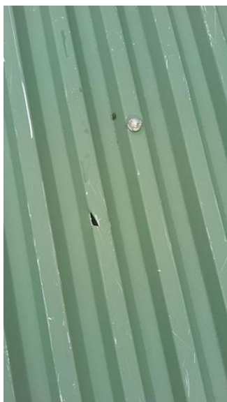
Helhetsvurdering - [Hull 2 i yttertak over stue]
