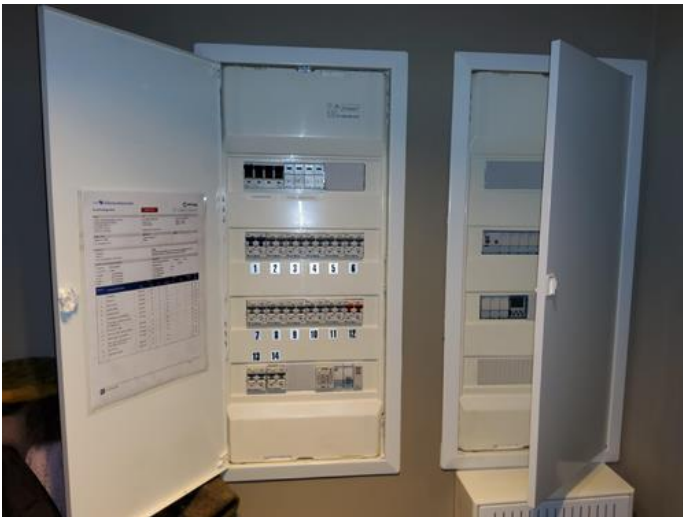
Elektrisk anlegg - [Sikringsskap. ]
