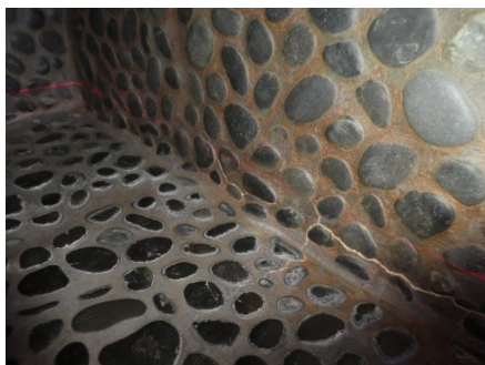
Noe sprekker i dusjsone
