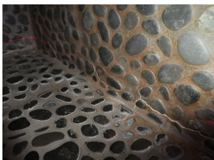
Noe sprekker i dusjsone
