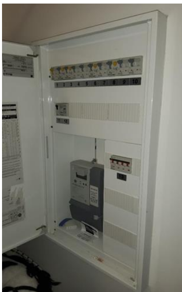
Elektrisk anlegg - [Sikringskap]
