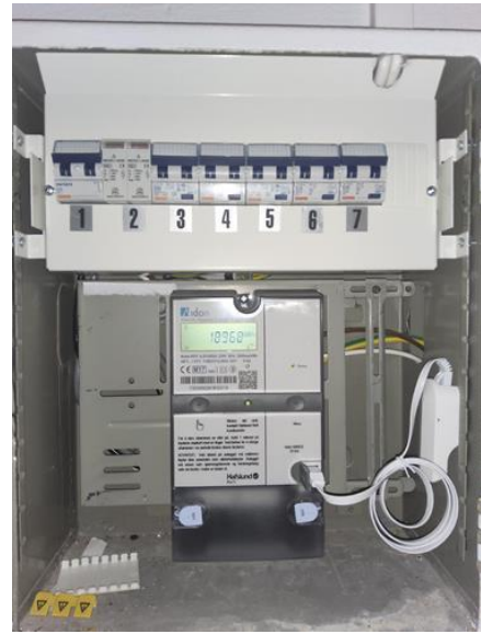
Elektrisk anlegg - [Sikringskap]
