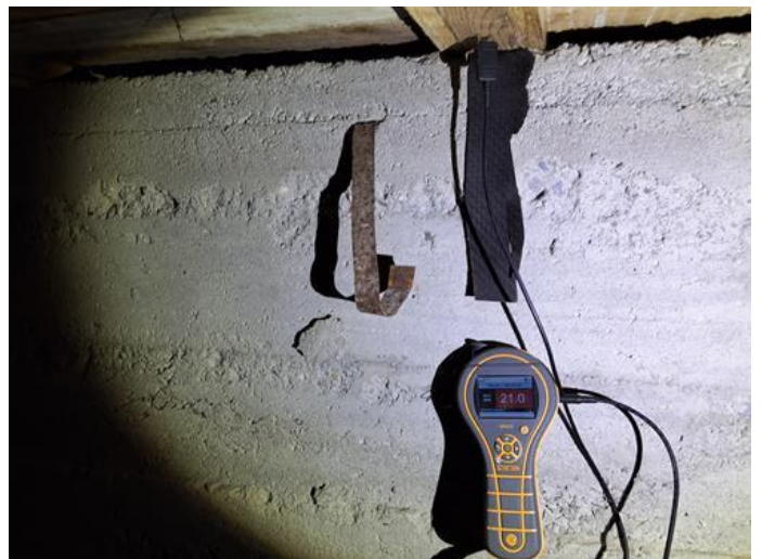
Innvendig - [Fuktmåling i bjelkelaget]
