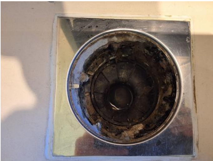
Våtrom - [Sluk ut på gulvet på badet]
