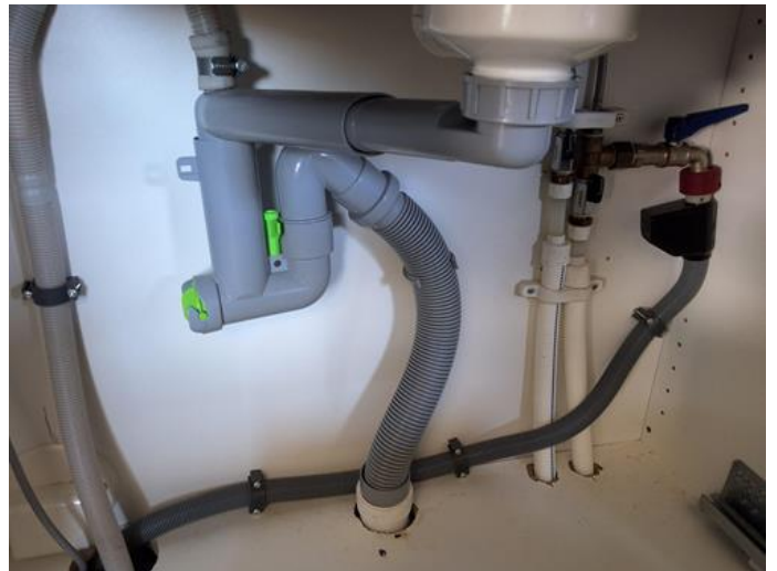
Kjøkken - [Rørpropp i kjøkkenbenk]
