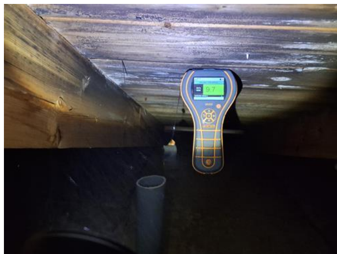
Loft - uinnredet / råloft - [Fuktmåling i undertaket]
