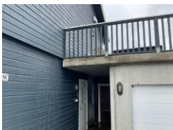
Det registreres skjevheter i dekke/betong over inngangsparti til 28C.
