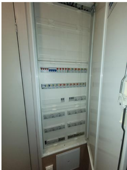
Elektrisk anlegg - [Sikringsskap hoveddel ]
