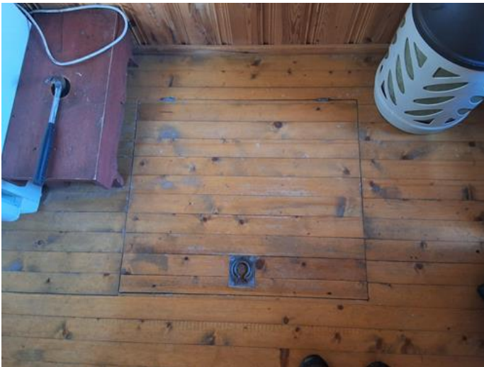
Innvendig - [Løse i gulvet]
