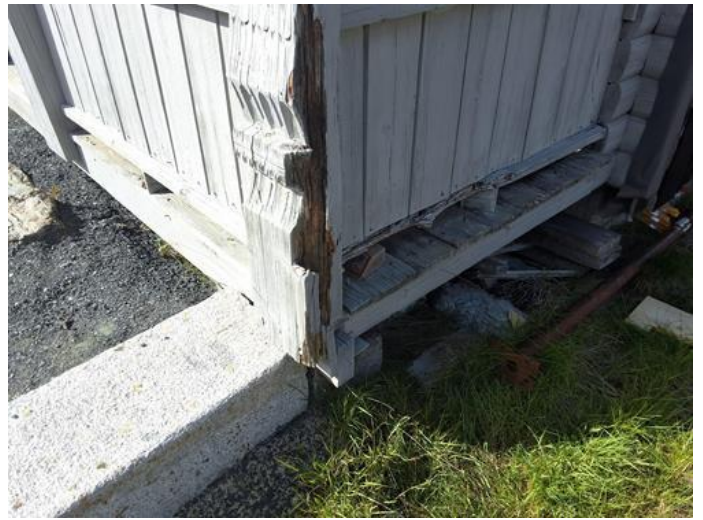
Utvendig - [Råteskade på søyle ved veranda]
