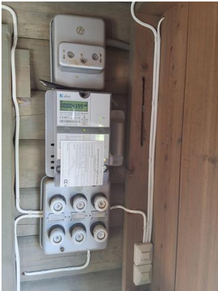
Elektrisk anlegg - [Sikringskap i entre.]
