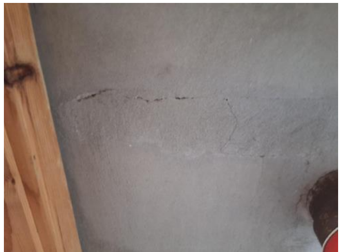
Innvendig - [Riss/spekk i pipe]
