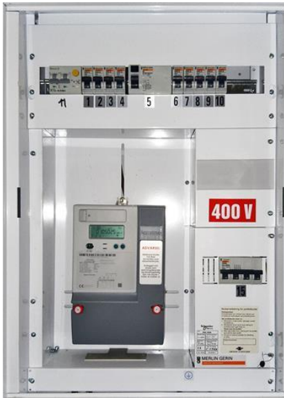
Forenklet vurdering av det elektriske anlegget - [Sikringskap]
