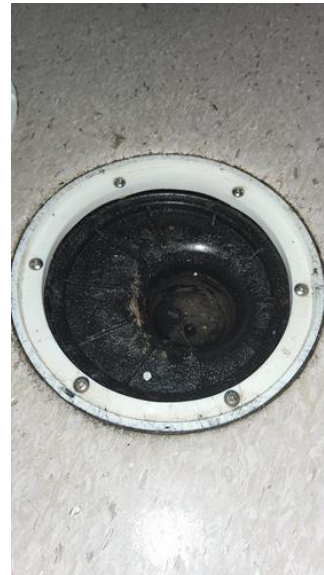
Avløpsrør (ink. sluk) - [Sluk vaskerom]
