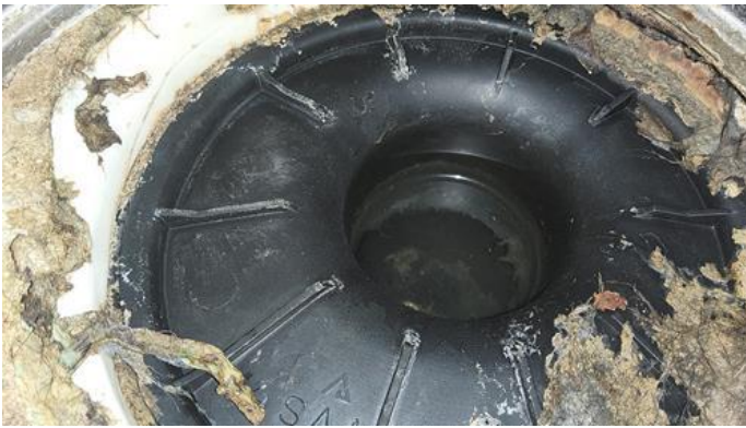
Avløpsrør (ink. sluk) - [Sluk bad]
