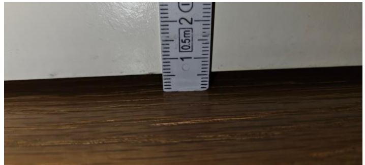
Spalte under dør
