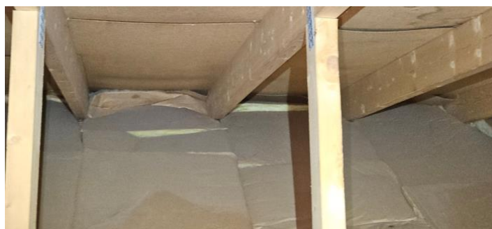
Luftespalte er klemt tett.
