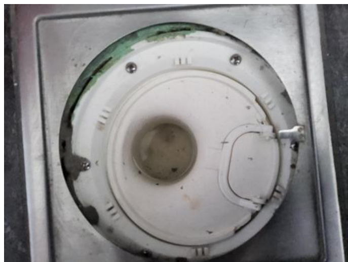
Avløpsrør (ink. sluk) - [Sluk på vaskerom. ]
