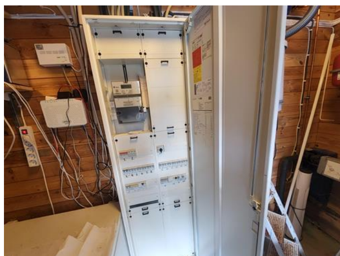
Elektrisk anlegg - [Sikringsskap. ]
