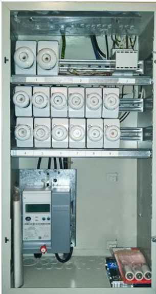
Forenklet vurdering av det elektriske anlegget - [Sikringskap]
