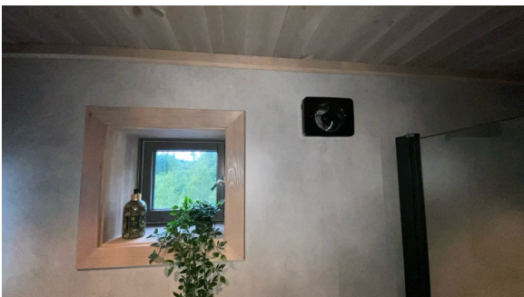
Mekanisk avtrekk på vegg og åpningsvindu
