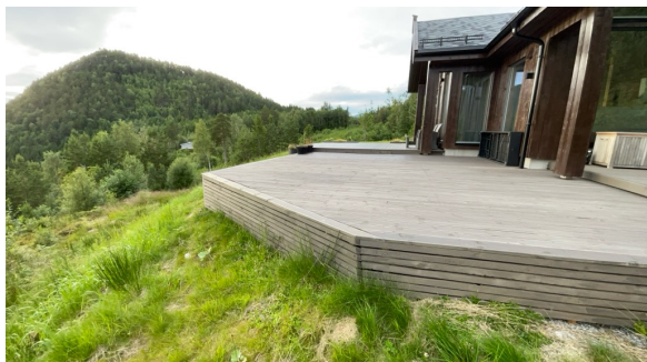
Det mangler rekkverk på en liten del av veranda i forkant av hytten.
