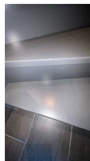
Små skader på enkelte trappetrinn
