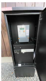
Utvendig inntaksskap med hovedbryter, AMS strømmåler og Elbillader overspenningsvern
