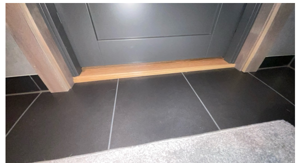
Tilluftsspalte under dør
