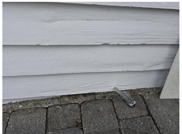
Fasader ink. kledning - [Eksempel på råteskadet kledning.]
