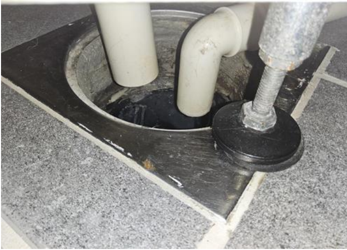
Avløpsrør (ink. sluk) - [Sluk bad]
