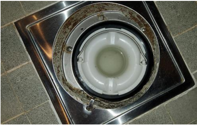
Avløpsrør (ink. sluk) - [Sluk bad ved entre.]
