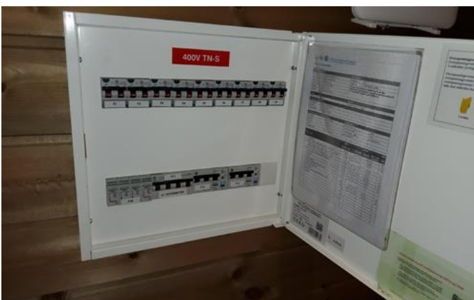
Elektrisk anlegg - [Sikringskap med kursfortegnelse.]
