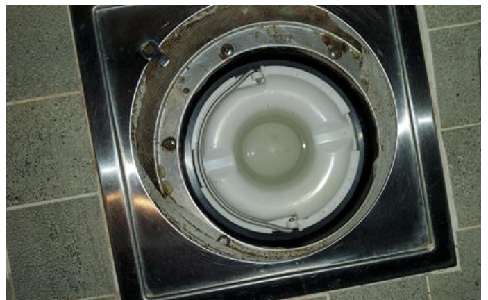
Avløpsrør (ink. sluk) - [Sluk bad ved soverom.]
