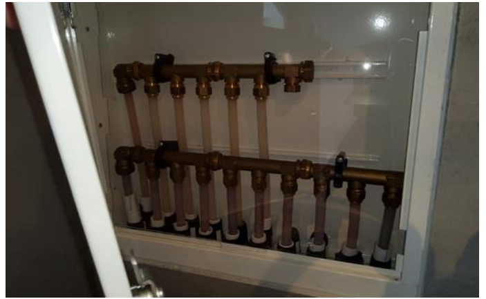
Tekniske anlegg, VVS anlegg (Sjekkpunkter utover det som er inkludert i andre rom) - [Fordelerskap på bad ved entre.]
