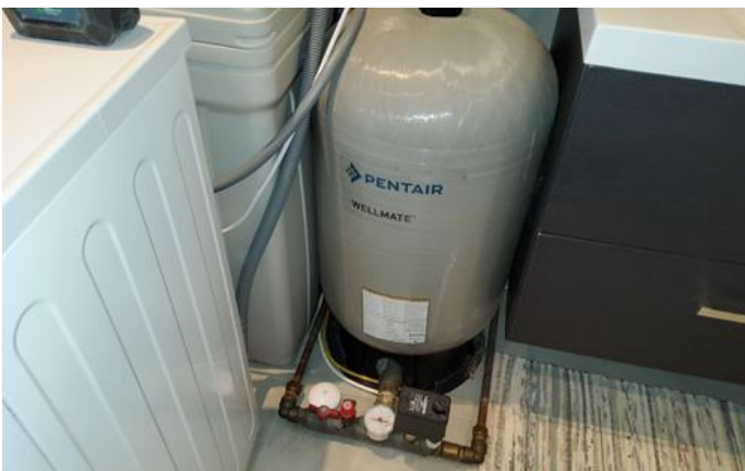
Tekniske anlegg, VVS anlegg (Sjekkpunkter utover det som er inkludert i andre rom) - [Trykktank.]
