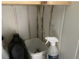
Fuktskadet veggplater og sopp i overflater.
