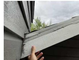
Bildet viser råteskade i vindski.
