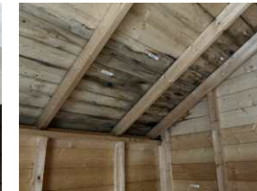
Bildet viser fuktskadet taktro, med sopp i overflater.
