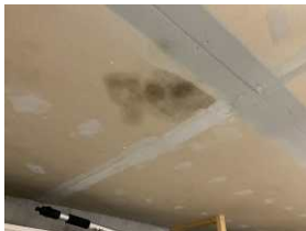
Fukt og sopp merker i himling inne i garasje.
