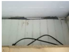
Fuktskadet veggplater og sopp i overflater.
