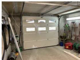
Det er leddport med portåpner i garasje.
