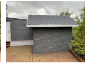
Bildet viser yttertak, med manglende beslag over vindskier.
