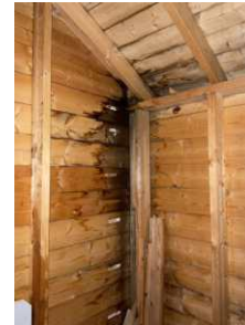
Bildet viser fukt- og råteskadet taktro og kledning, med sopp i overflater.
