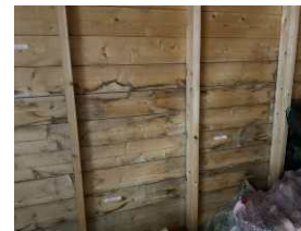
Bildet viser fuktskadet kledning, med sopp i overflater.
