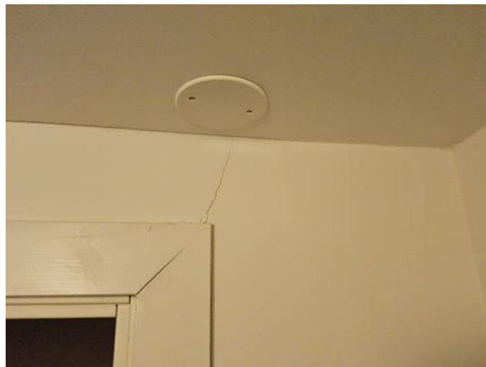
Kommentar - [Sprekk/riss vaskerom]
