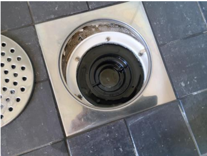
Avløpsrør (ink. sluk) - [Sluk bad]
