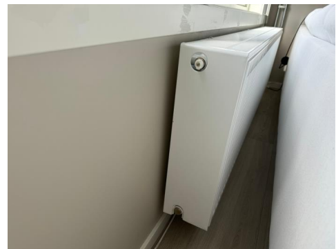
Radiatorovn i stue.
