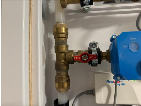
Stoppekran i rør i rør skap.
