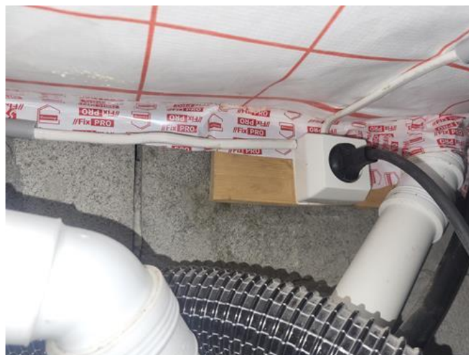
Elektrisk anlegg - [Stikkontakt til avfukter]
