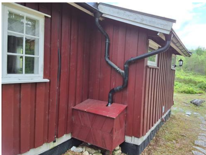
Utvendig - [Takvann ført ned i filterløsning, før det ledes inn i vannmagasin. ]
