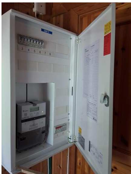
Elektrisk anlegg - [Sikringskap på soverom ]
