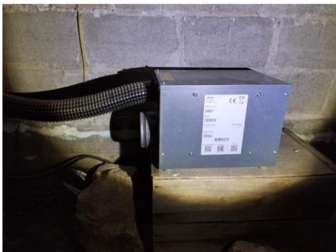
Krypekjeller - [Avfukter i krypkjeller]
