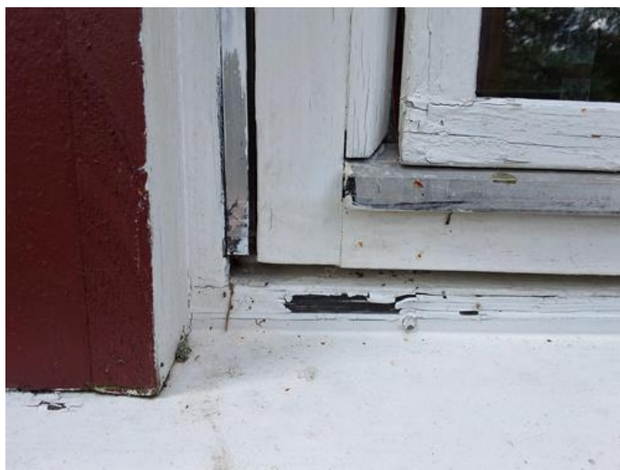
Utvendig - [Slitasje på vinduer]
