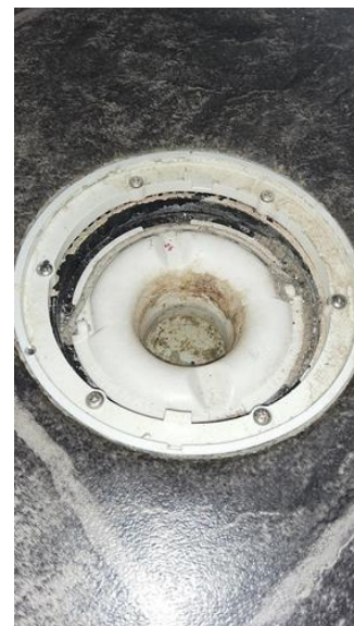
Avløpsrør (ink. sluk) - [Sluk vaskerom]
