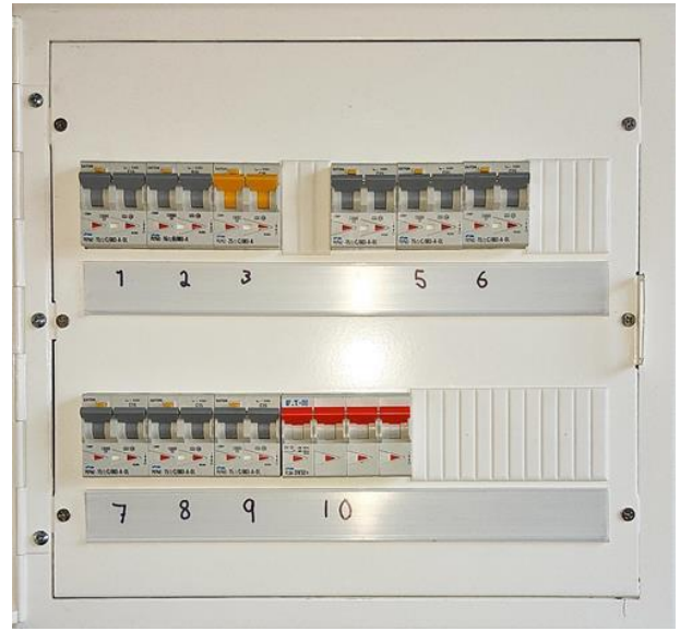
Forenklet vurdering av det elektriske anlegget - [Sikringssskap leilighet]
