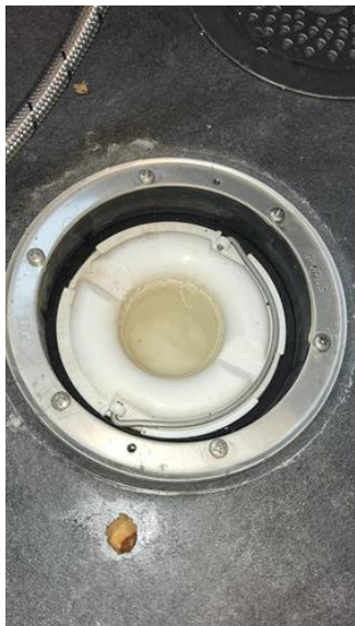
Avløpsrør (ink. sluk) - [Sluk bad loftsetasje]
