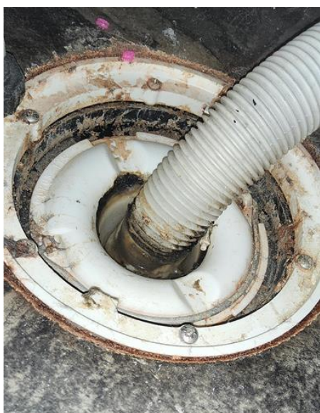
Avløpsrør (ink. sluk) - [Sluk bad 1. etasje under badekar]
