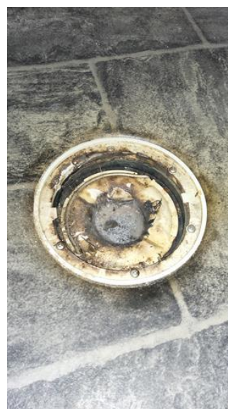
Avløpsrør (ink. sluk) - [Sluk bad underetasje]
