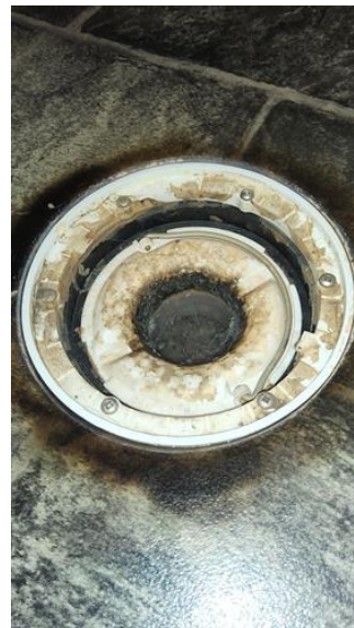
Avløpsrør (ink. sluk) - [Sluk bad 1. etasje i dusj]
