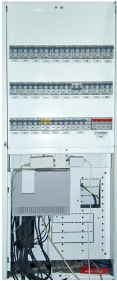
Forenklet vurdering av det elektriske anlegget - [Sikringssskap hoveddel]
