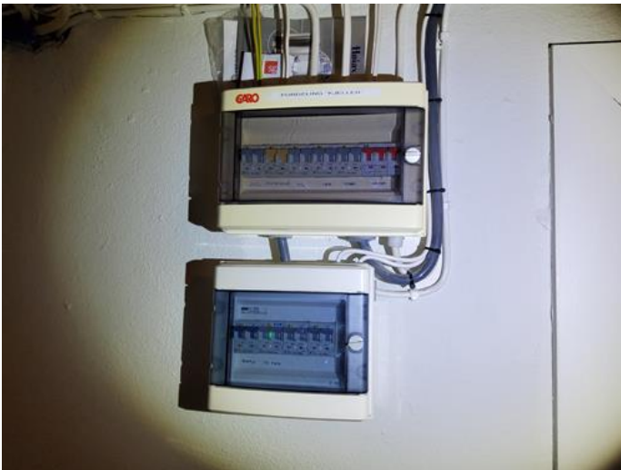
Beskrivelse - [Sikringskap kjeller]
