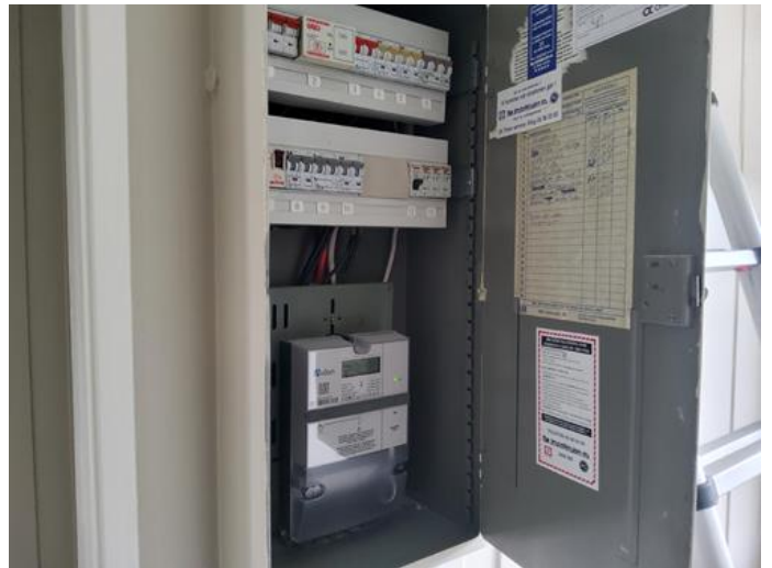
Elektrisk anlegg - [Sikringskap loftetasje]
