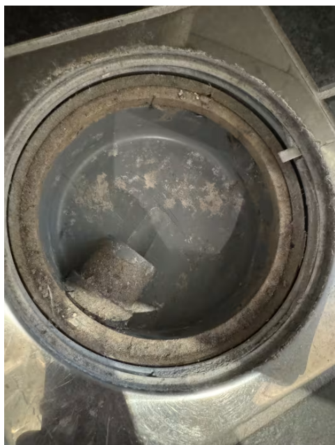
Sluk i plast under innredning.
