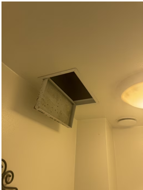
Luke i himling for rør- i rør system med stoppekraner.
