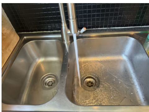
Det ble ved kapasitetstesting registrert godt vanntrykk og god avrenning.
