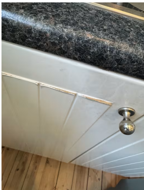
Stedvis noe slitte overflater i innredning.
