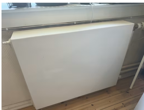
Radiatorer i stue og kjøkken.
