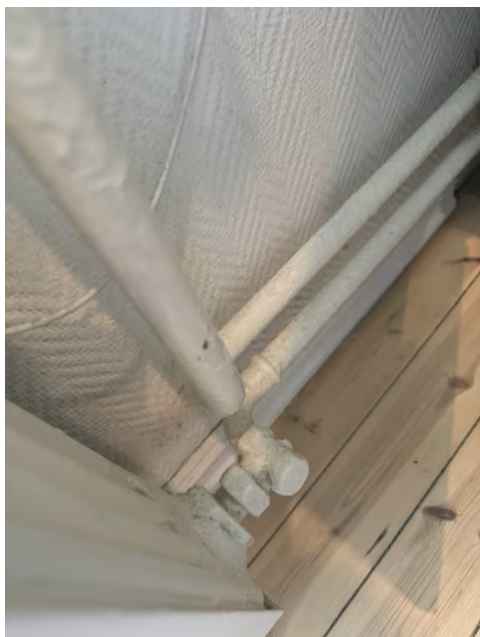
Eldre rør til vannbåren varme.
