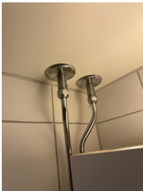
Vannrør i metall på bad.
