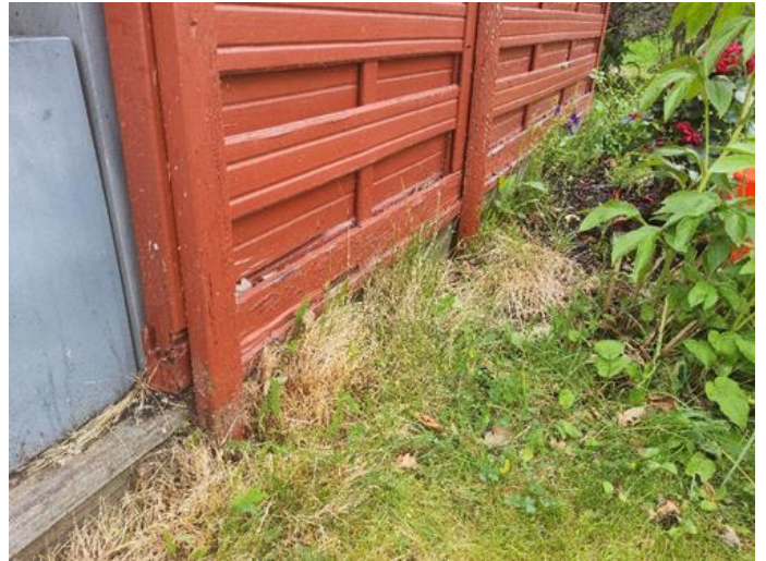
Terrasser / platting på terreng - [Eksempel på slitasje og råteskader på terrasseplatting ]
