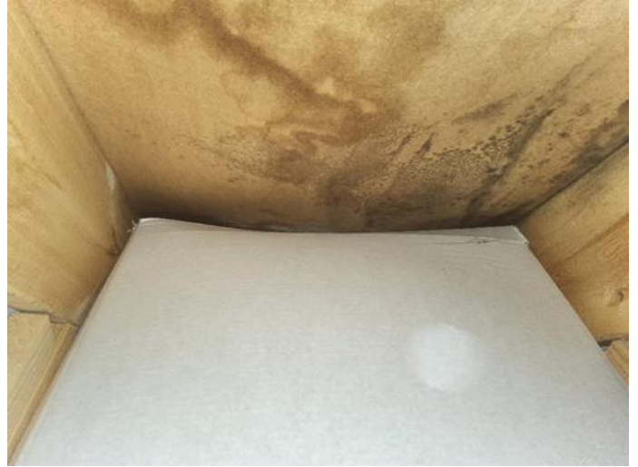
Loft - uinnredet / råloft - [Eksempel på fuktskjolder i taket i kott]
