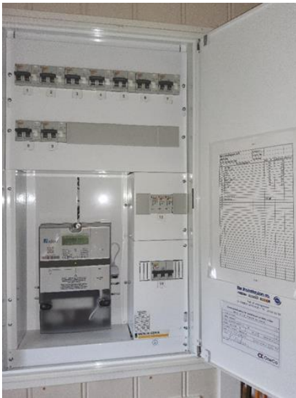
Elektrisk anlegg - [Sikringsskap og kursfortegnelse ]
