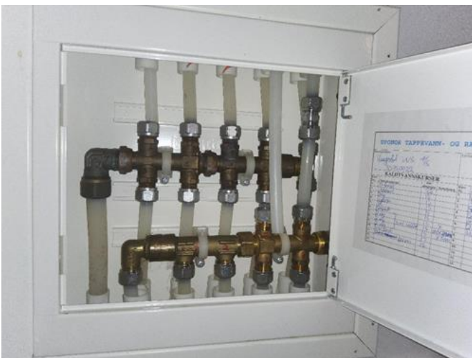
Tekniske anlegg, VVS anlegg (Sjekkpunkter utover det som er inkludert i andre rom) - [Fordelerskap for rør-i-rør system]
