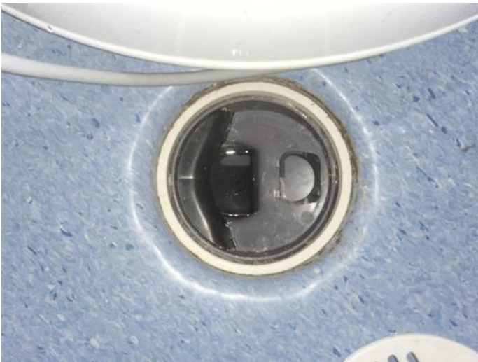
Avløpsrør (ink. sluk) - [Sluk ved varmtvannsbereder på bad]
