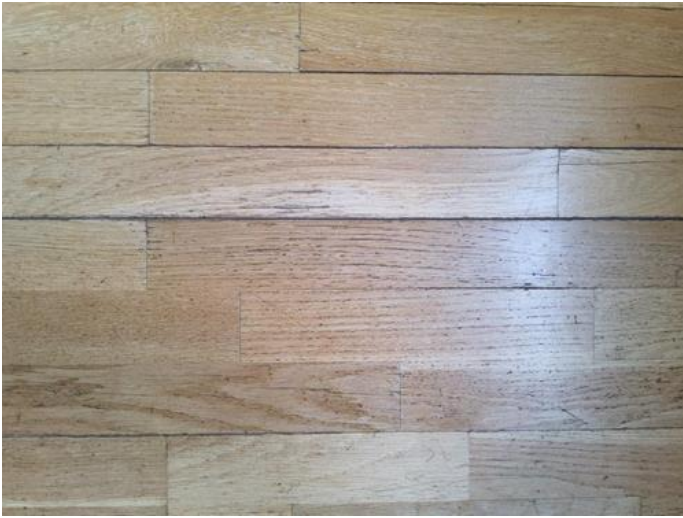
Øvrige rom [eksklusive spesialrom] - [Eksempel på fuktskadet parkett]
