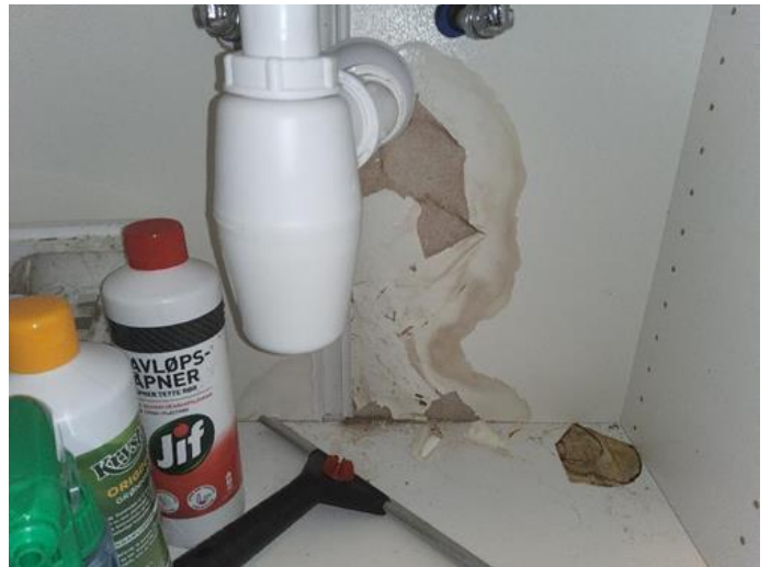
Sanitærutstyr / innredning - [Eksempel på fuktskade i skap på bad]
