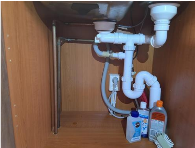
Kjøkkenen - [Røropplegg i kjøkkenbenk]
