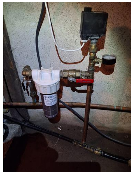
Hovedstoppekran - [Stoppekran og trykkvak til brønnpumpe. ]
