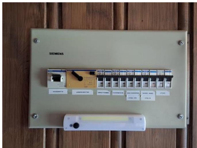
Elektrisk anlegg - [Fordelerskap sikringer i gang]
