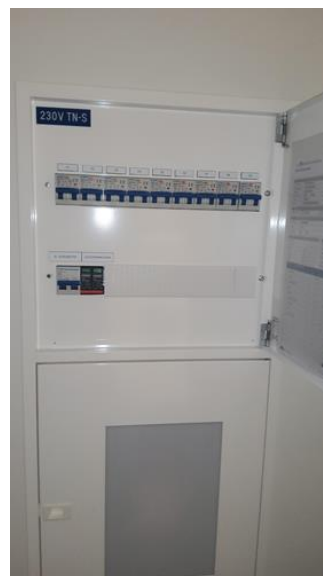
Elektrisk anlegg - [Sikringsskap]
